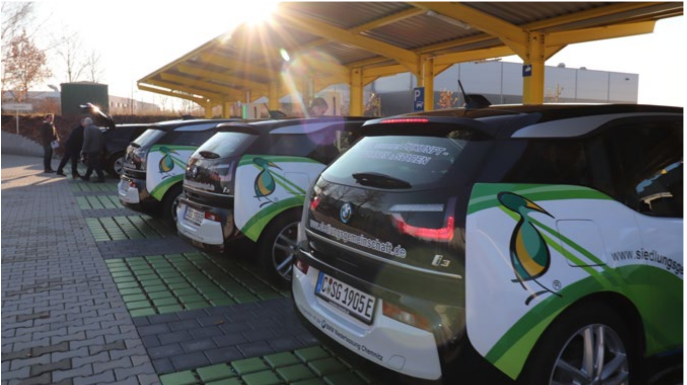
Ladeinfrastruktur auf dem Gelände der HEOS
